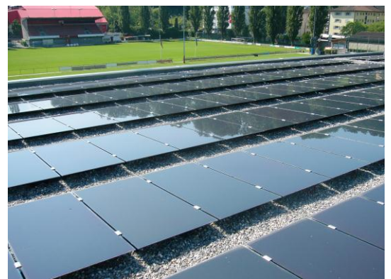
Photovoltaic system for the Lucerne Spieleute pavilion
